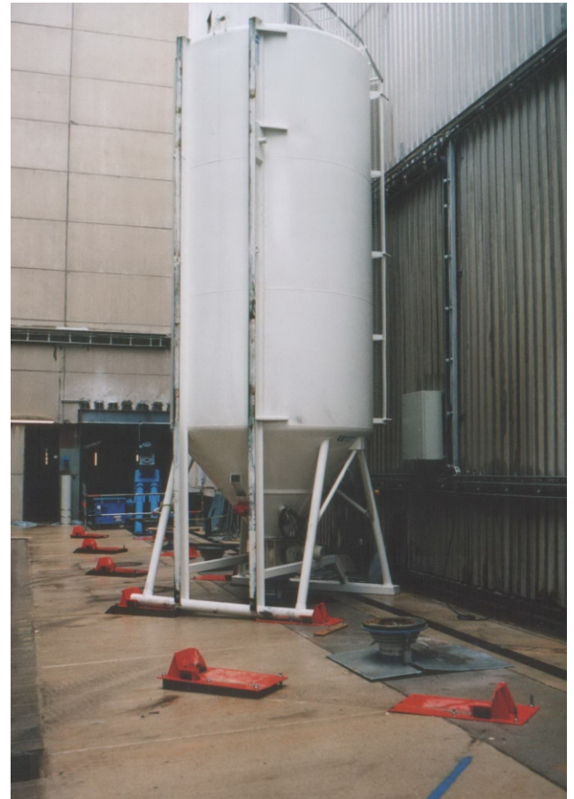
Silo auf Andockstation mit Rohrkettenförderer unterirdisch
